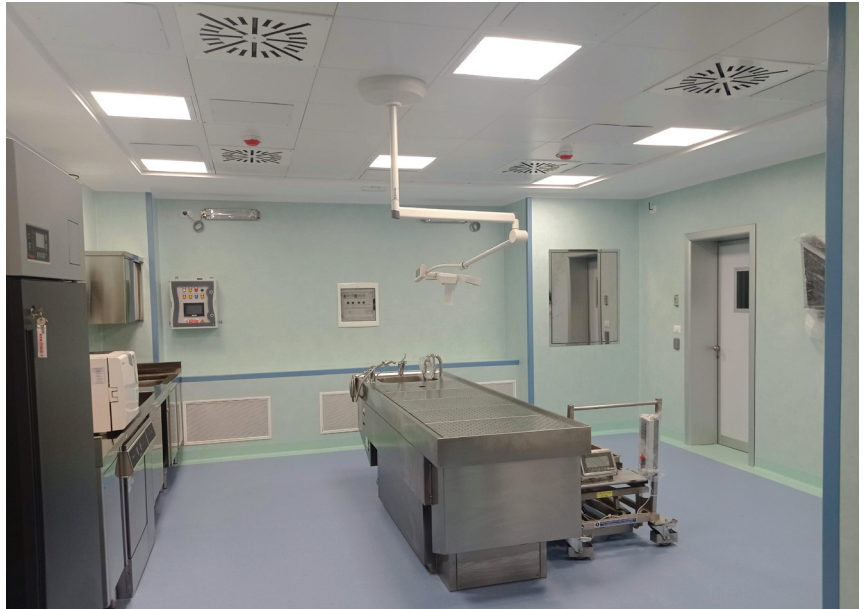
■ Sala settoria. Da notare le bocchette del sistema che garantisce il costante ricambio dell'aria (in alto, di forma circolare, per l'immissione) e in basso (di forma rettangolare, per l'aspirazione). Nell'angolo a destra (sportello a specchio) l'ubicazione del filtro HEPA atto a trattenere qualsivoglia agente patogeno aereo prima dell'espulsione all'esterno della sala.
