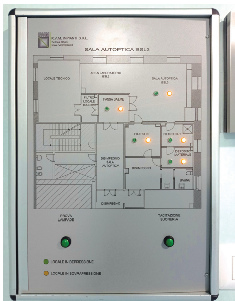
■ Pannello di controllo esterno ai locali che nel complesso costituiscono l'area BSL3, inclusa la sala settoria. La visualizzazione della corretta presenza dei gradienti pressori nei locali permette l'accesso agli stessi.
