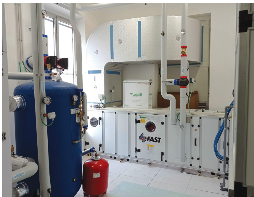
■ Locale tecnico con sistemi per il trattamento dell'aria.
